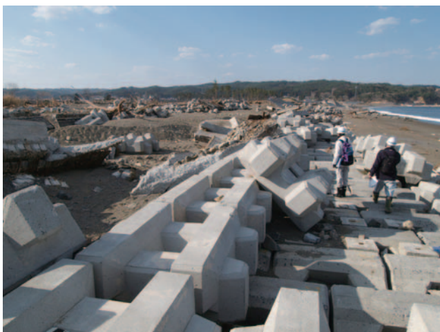
図-5. 破壊された防潮堤 1(岩手県野田村十府ヶ浦, 2013年4月12日)
