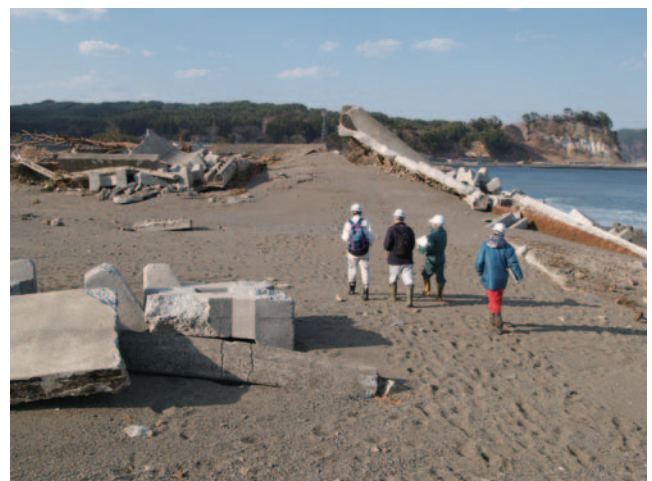
図-6. 破壊された防潮堤 2(岩手県野田村十府ヶ浦, 2013年4月12日)
